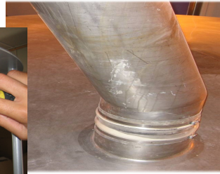
Problemas de acumulación de residuos
