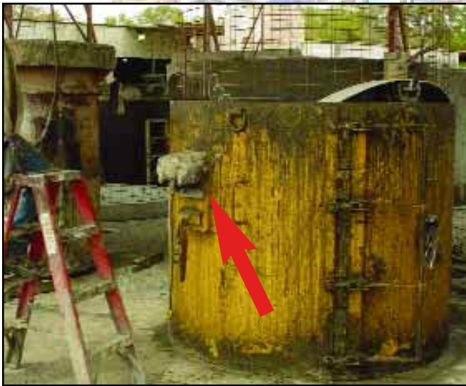
US-1600 on manhole
