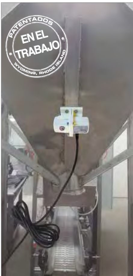
Una unidad SCR (página 38 y 39) instalada en esta tolva ofrece velocidad y potencia ajustables con funcionamiento continuo de alta resistencia.
